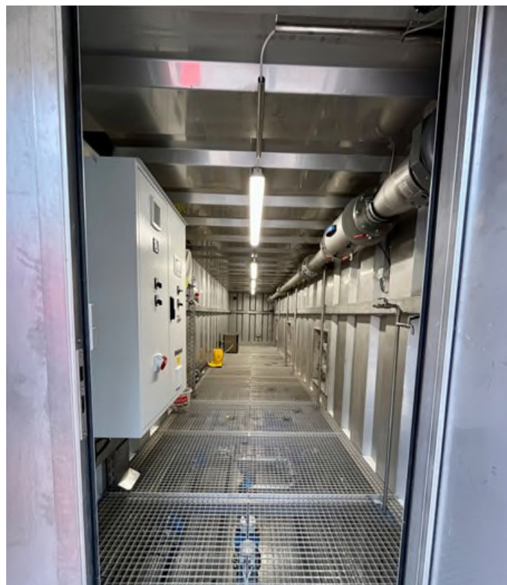
Beispiel Technikraum Hochbehälter Arnoldstein/Kärnten – von uns besichtigt
